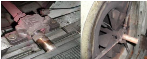
Figura 10 – Verificação e lubrificação nos rolamentos do motor e ventilador
